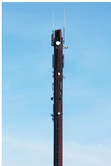
Antenner monteret på skorsten
