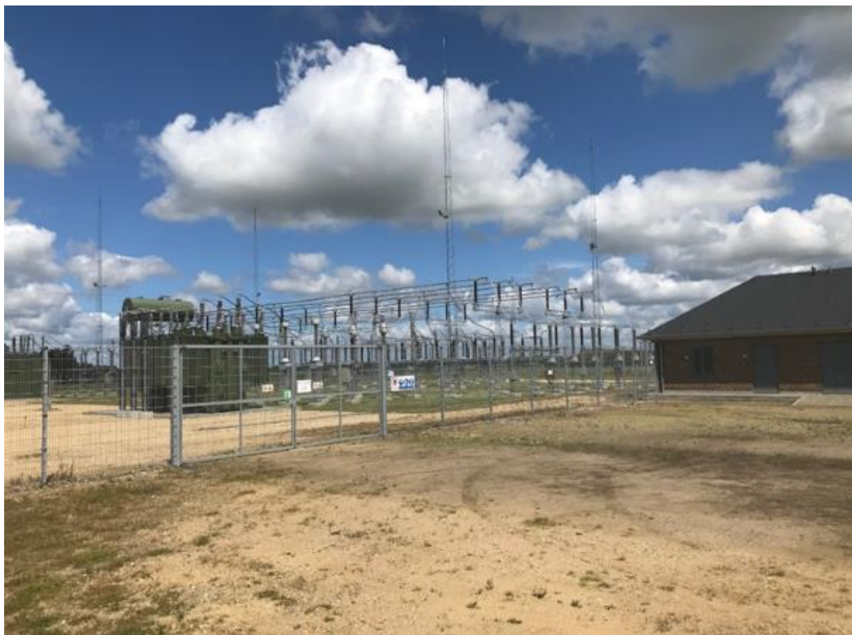
Figur 2.4: Eksempel på step-up transformere med tilhørende udendørs tekniske konstruktioner.
