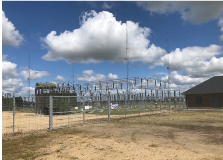
Figur 5. Eksempel på step-up transformer med tilhørende udendørs tekniske konstruktioner.
