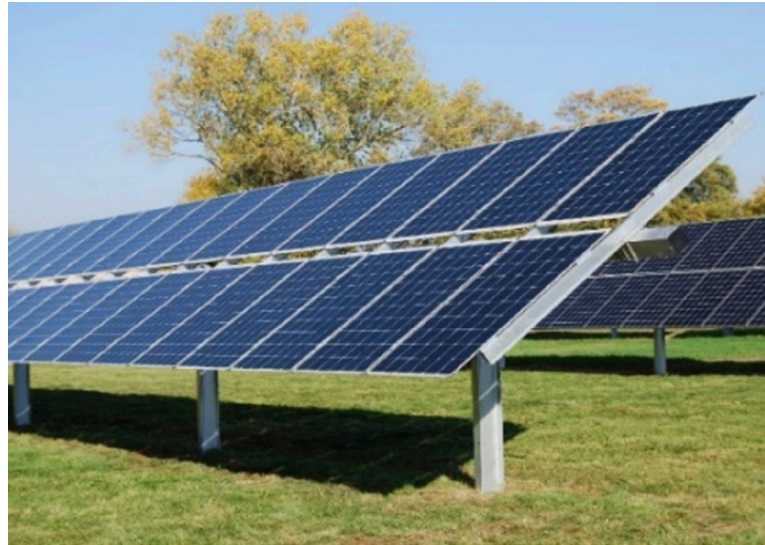
Figur 3. Eksempel på solceller monteret på trackere.
