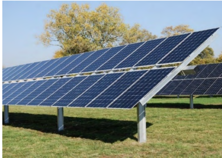
Figur 3. Eksempel på solceller monteret på trackere.
