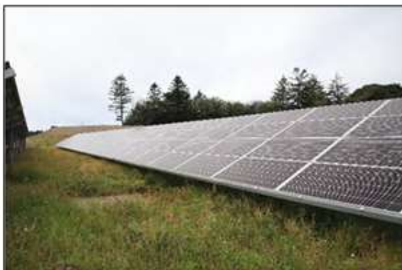
Figur 9: Solceller monteret på faste stativer.
