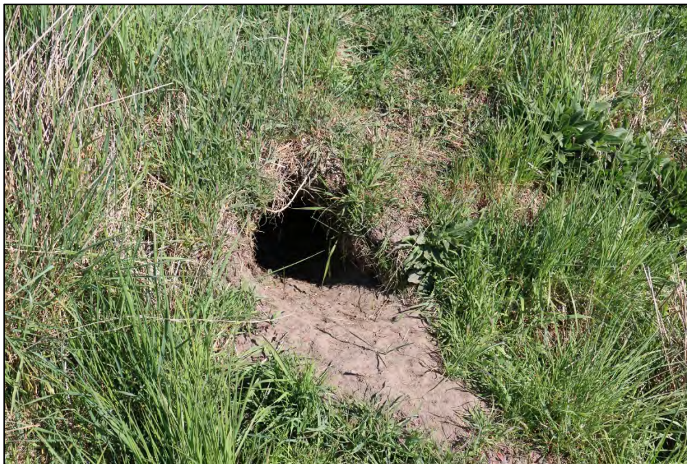
Figur 3-24 Foto fra COWIs besigtigelse, april 2021. Rævegrav der er fundet i diget.
