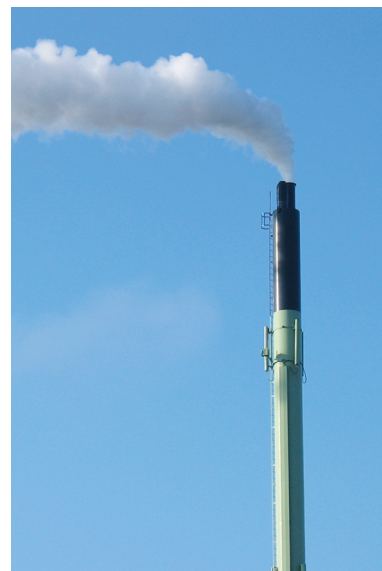
Antenner monteret på skorsten
