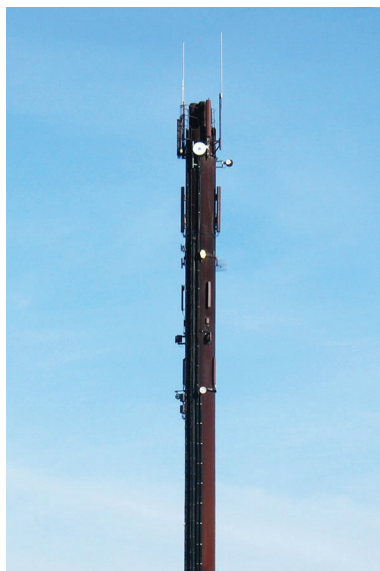
Antenner monteret på skorsten
