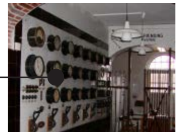
Elementer fra transformerstationen
