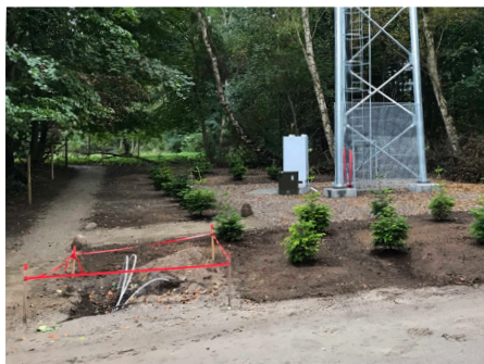
Der sikres en mindre åbning i beplantningsbæltet, så masten kan tilgås i forbindelse med service mv.
