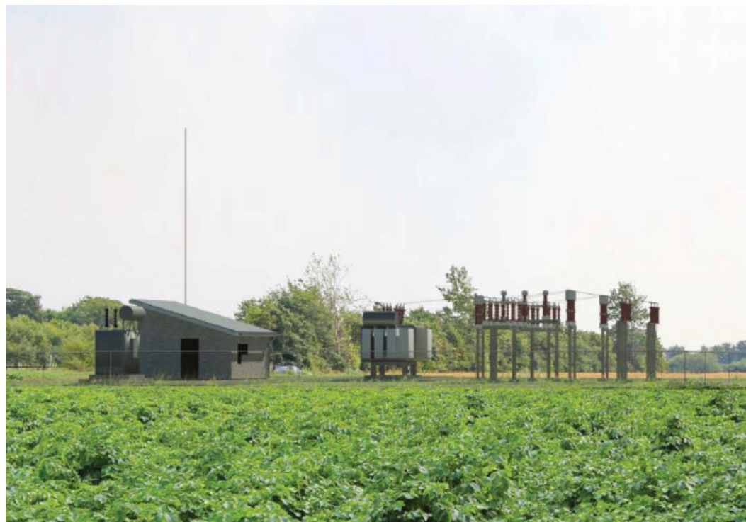
Figur 5.7: Eksempel på stepup transformer med tilhørende 15 meter høj lynafleder omkranset af trådhegn, inden afskærmende beplantning er etableret.
