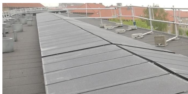
Solceller monteret på fladt tag, som en øst/vest vendt løsning
