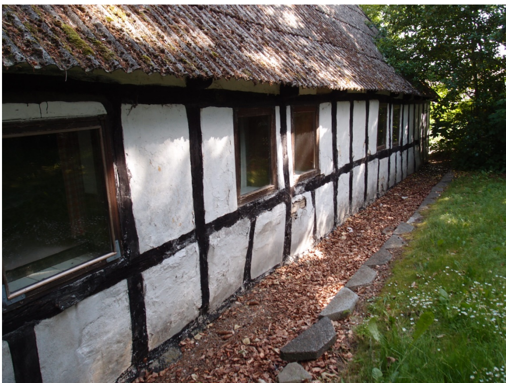
Stuehus, facade mod syd. Bindingsværket er i meget ringe stand.
