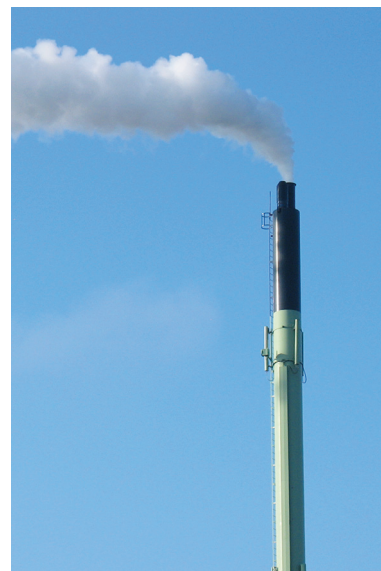
Antenner monteret på skorsten
