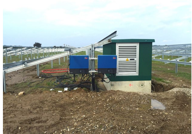
Invertere (blå) og step-up transformere i anlægget
