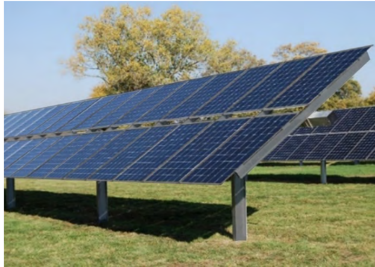
Figur 3. Eksempel på solceller monteret på trackere.
