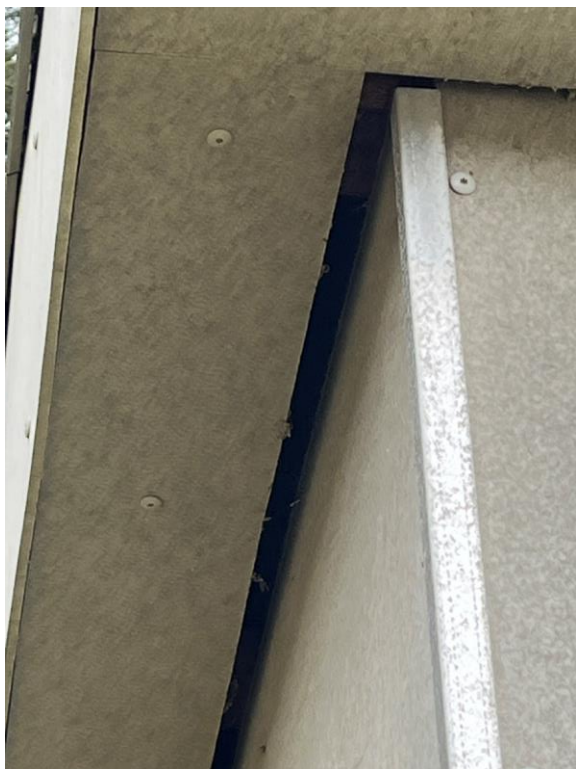
Figur 5-10: Tilsyneladende defekt spærring af mellemrum mellem væg og udhæng, østlige bygning, Tåstrup-Feldballe Renseanlæg.
