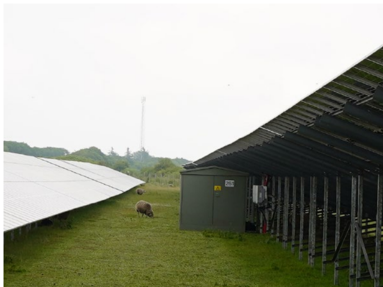
Figur 4. Eksempel på en fordelingstransformer, placeret mellem rækker med solcellepaneler.
