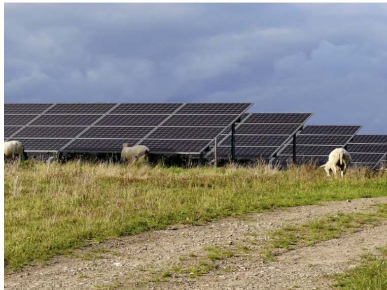
Figur 2. Eksempel på solceller monteret på faste stativer.
