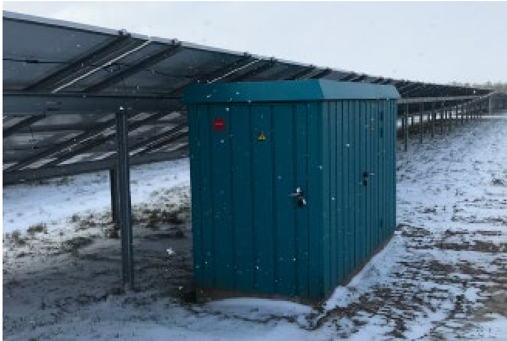
Figur 1-5 Eksempel på transformer.
