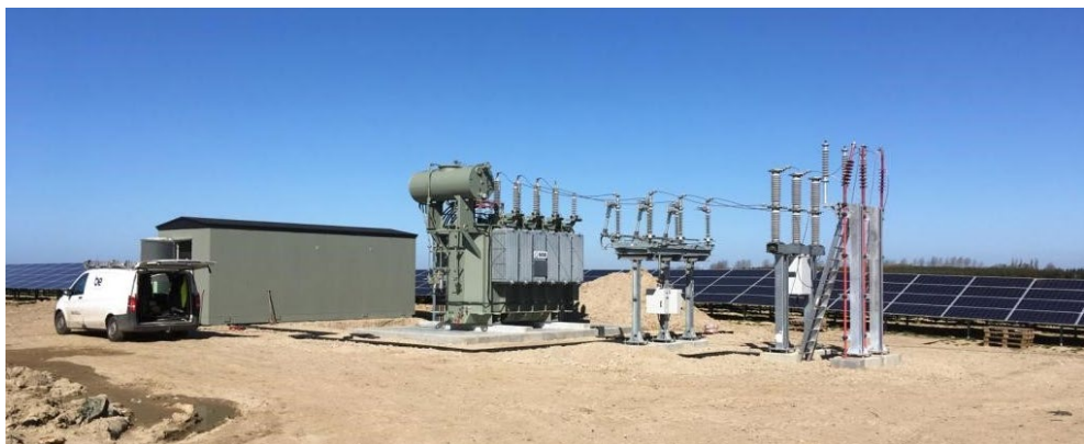
Figur 1-6 Eksempel på stepup-transformer og teknikbygning.
