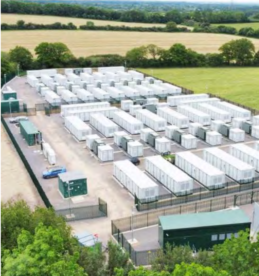
BESS-anlæg – Modulopbygning med 20-fods containere og invertere.
