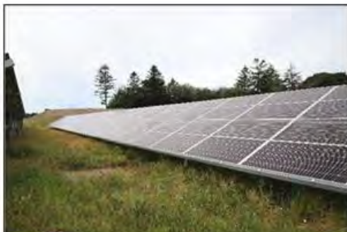
Figur 9: Solceller monteret på faste stativer.
