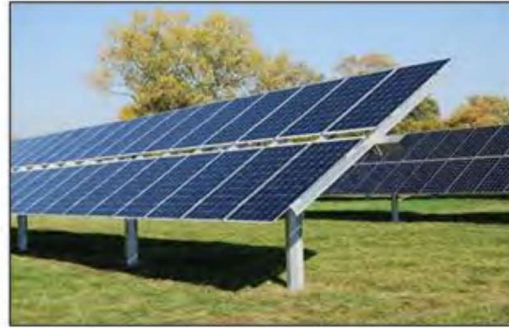
Figur 10: Solceller monteret på bevægelige stativer.
