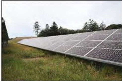
Figur 9: Solceller monteret på faste stativer.
