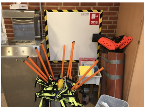
Der må ikke står noget foran slangeskabene
