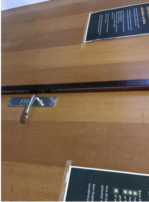
Branddør lukke ikke tæt
