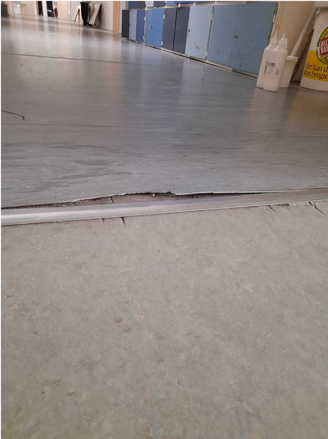
Gulv ved indgang til podegangen.
